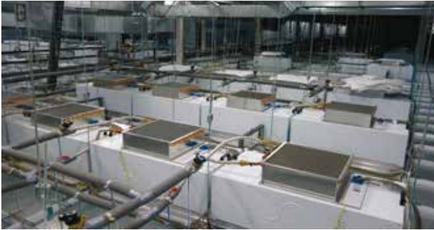
Рис. 9. Подвесной потолок с установленными ФВМ
