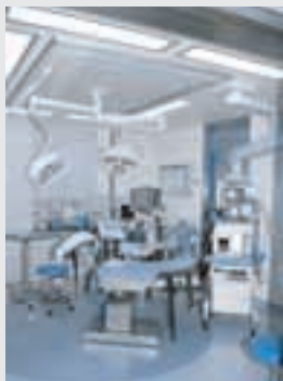
Модуль циркуляции, встроенный в стену
